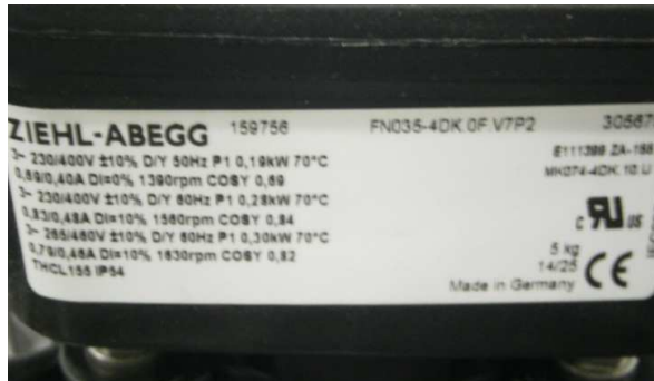
Photo #4 Fan motor nameplate
